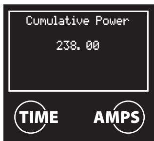
Obrazovka celkové hodnoty energie
