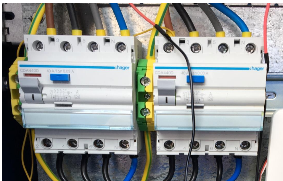
Obrázek 9: Sestavení proudových chráničů uvnitř stanice
